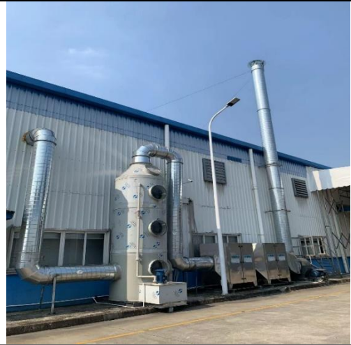
排气筒 DA005 处理设备
