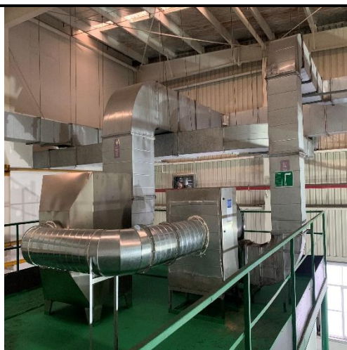
排气筒 DA001 处理设备
