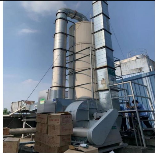
排气筒 DA002 处理设备
