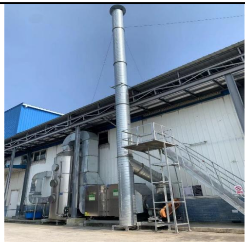
排气筒 DA004 处理设备
