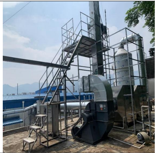
排气筒 DA003 处理设备
