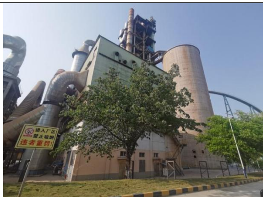
4000t/d 熟料生产线窑尾废气处理措施
