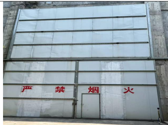
水泥散装库顶除尘器
