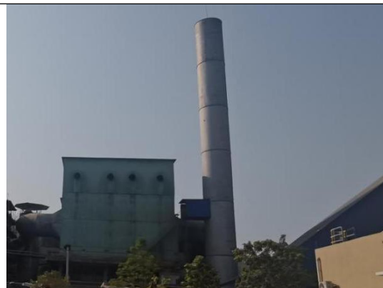
4000t/d 熟料生产线窑头废气处理措施
