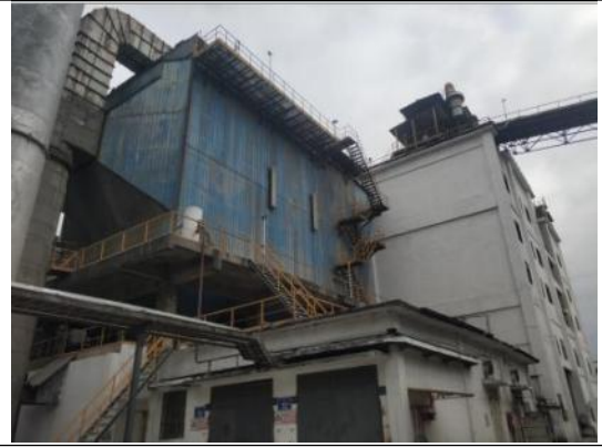
布袋除尘设施
