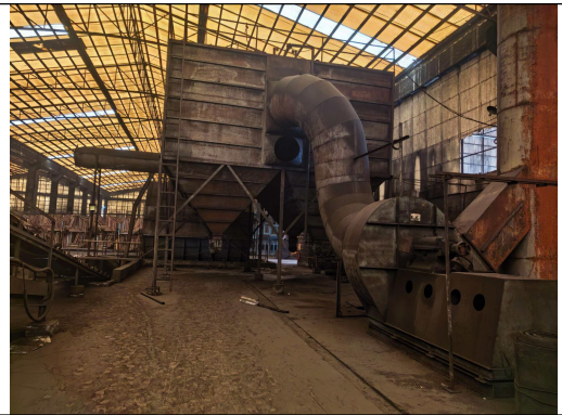
煤仓布袋除尘器
