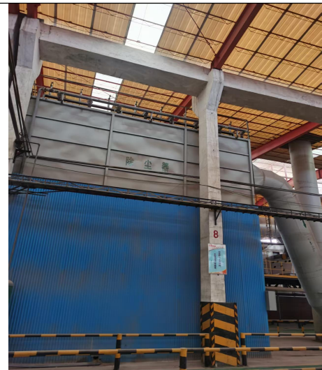
压机布袋除尘器
