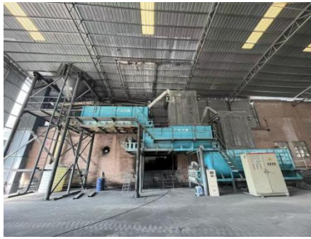
消化工序除尘设施
