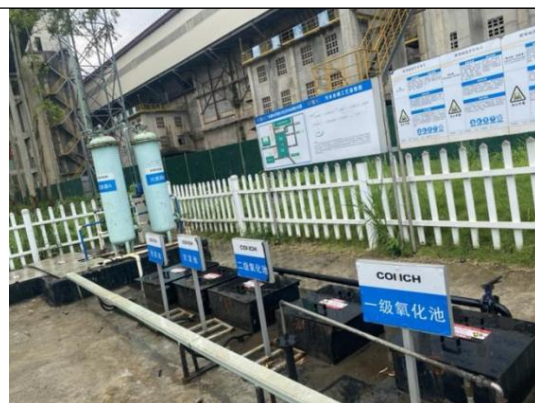
联合储库生活污水处理系统
