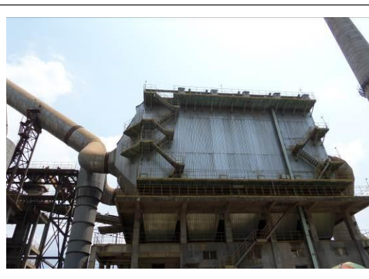
A 线窑尾电除尘器
