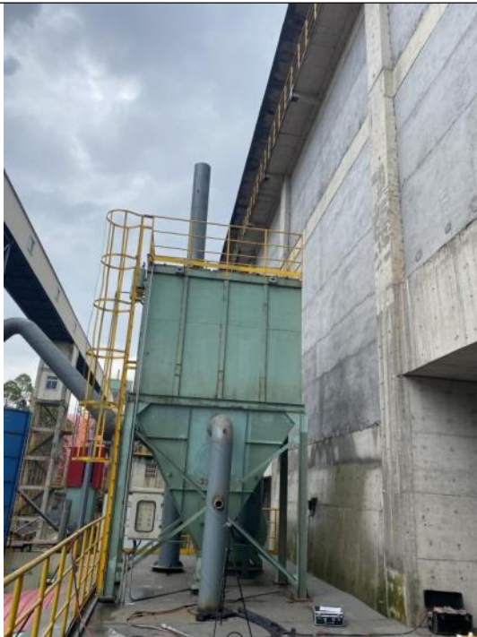
其他产生点除尘器(部分)
