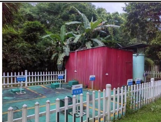
生活区生活污水处理系统
