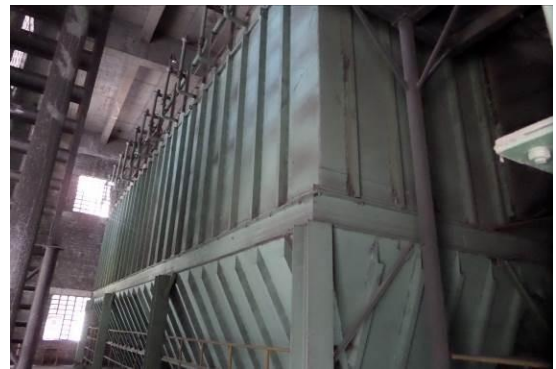
水泥粉磨除尘器
