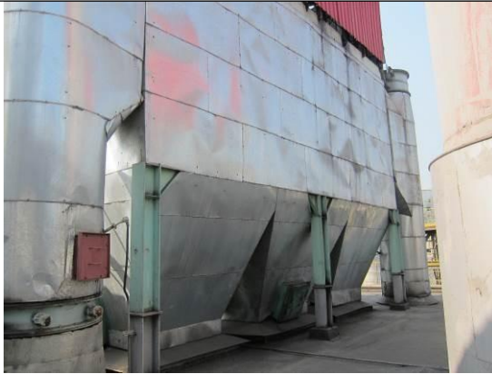
B 线煤磨主袋除尘器
