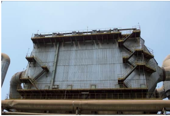
B 线窑尾电除尘器
