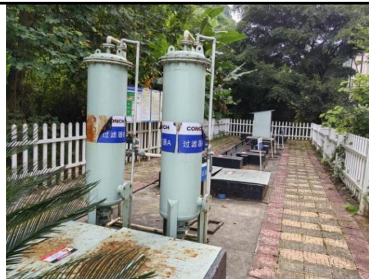
中控楼生活污水处理系统
