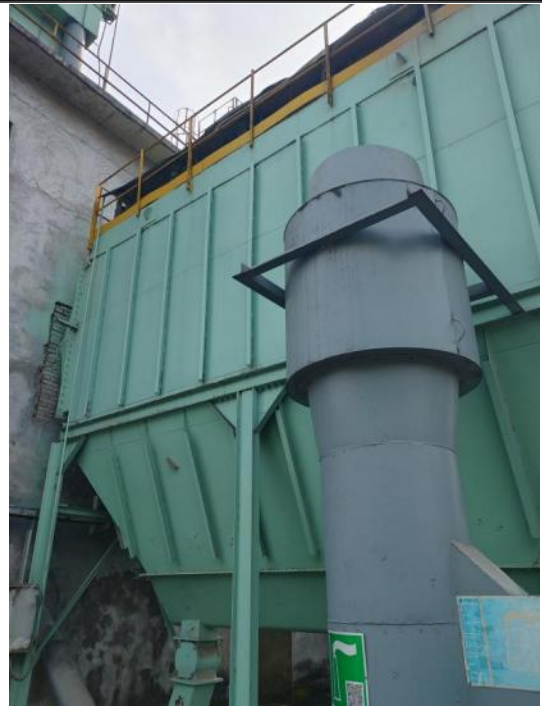
其他产尘点除尘器(部分)
