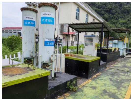
水泥发散广场生活污水处理系统
