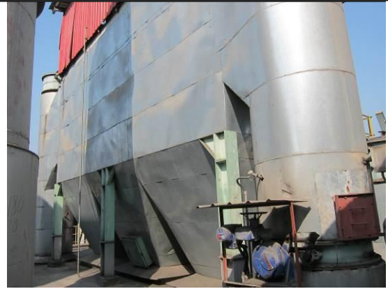
A 线煤磨主袋除尘器
