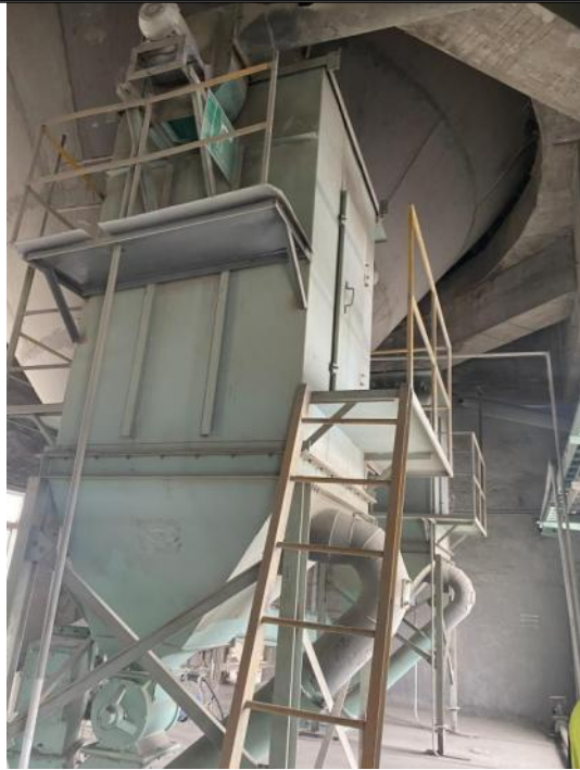
其他产尘点除尘器(部分)
